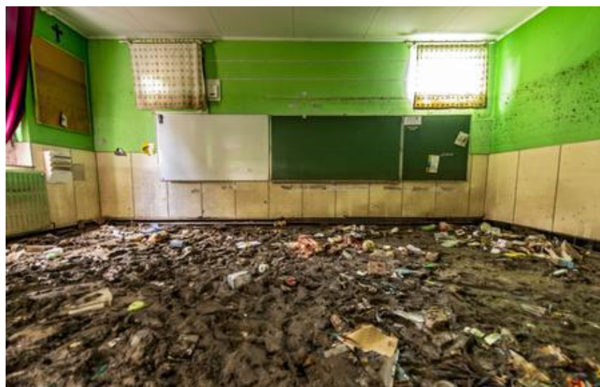
Les inondations offrent l'occasion de réfléchir au rôle du maître architecte, notamment pour reconstruire les écoles. © PHOTO NEWS.
